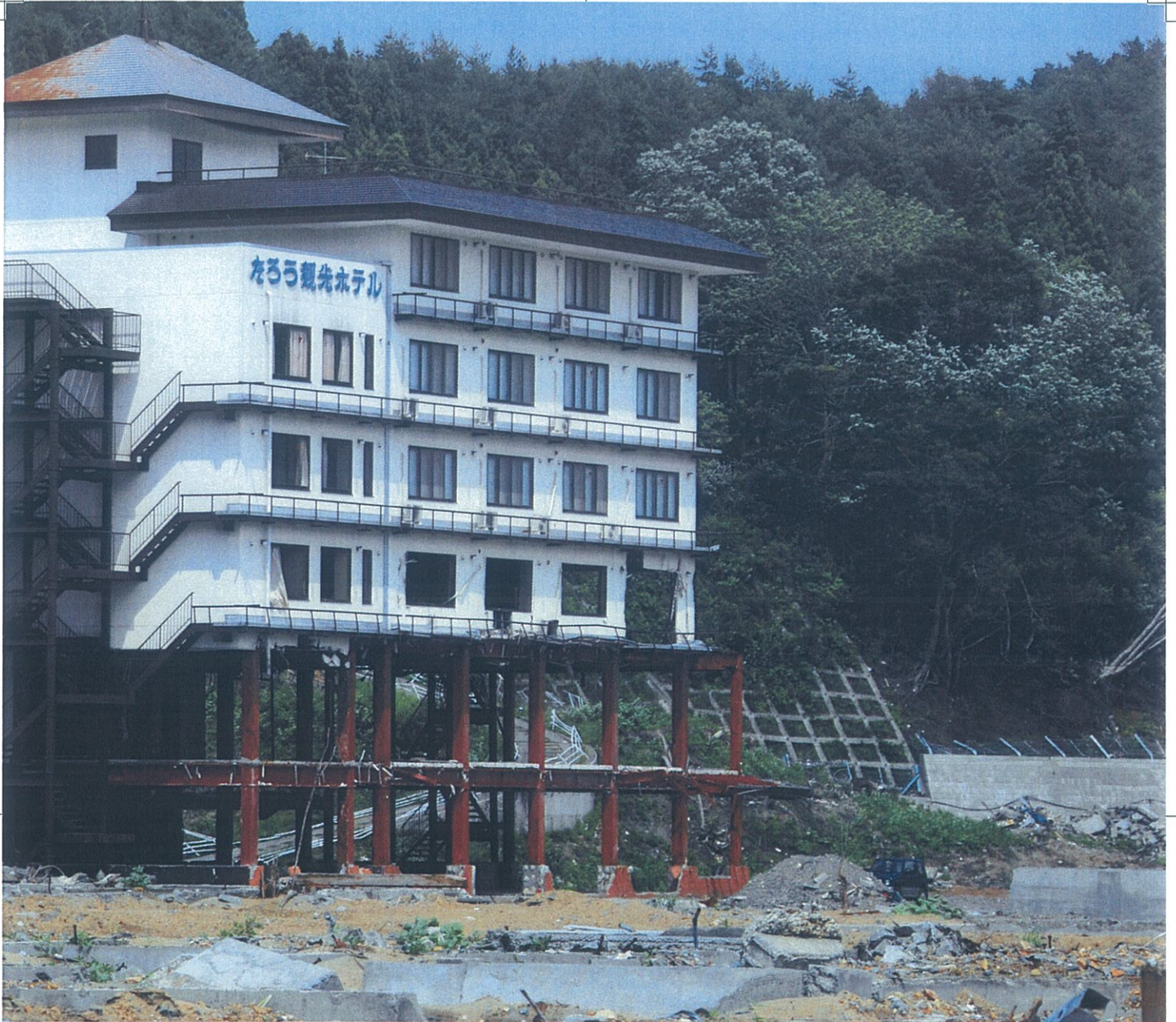
写真1 2013年9月24日に、日本ジオパークに認定された三陸ジオパークのジオサイトの一つ。宮古市田老地区の「たろう観光ホテル」は、3階まで津波で破壊された建物をそのまま災害遺構として残し、ジオサイトとして登録されている。
