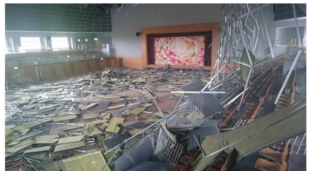
写真 5 本震後、天井パネルが落下した益城町総合体育館アリーナ（2016 年 4 月 16 日、益城町提供）
